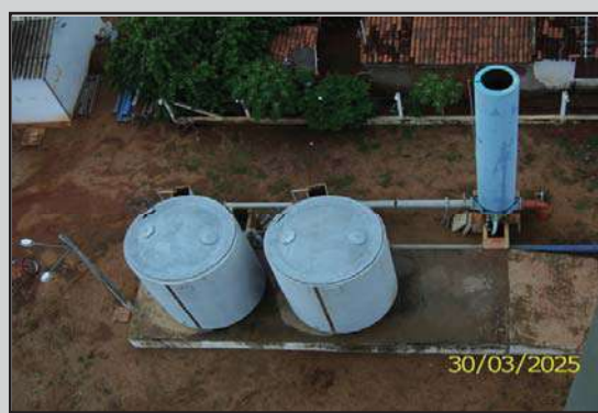
Depois: Filtros ascendentes com tampas de proteção (fiscalização de acompanhamento em 30 e 31 de março/2005)
