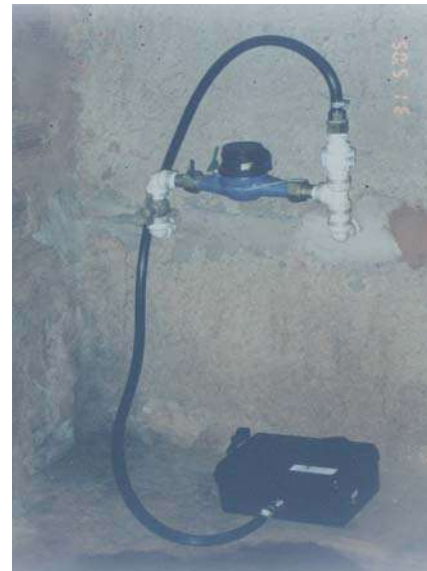
Figura 20 - Medição de pressão com manômetro e data logger
