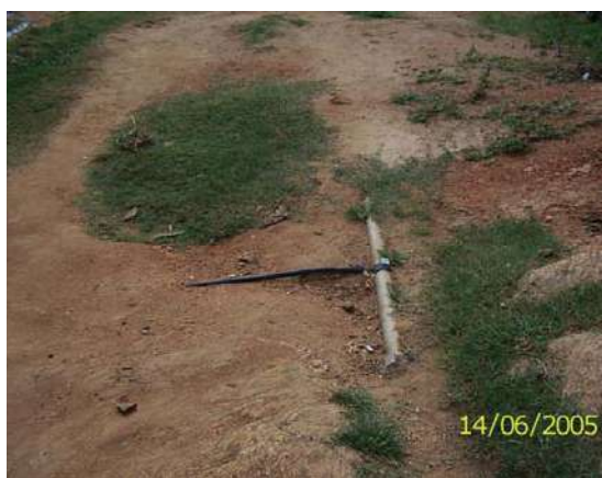
Figura 21 - Rede e ramal de ligação expostos
