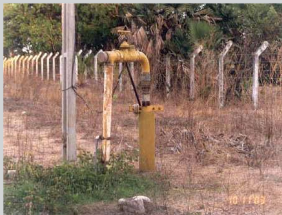
Figura 8 - Manancial subterrâneo sem a infra-estrutura adequada
