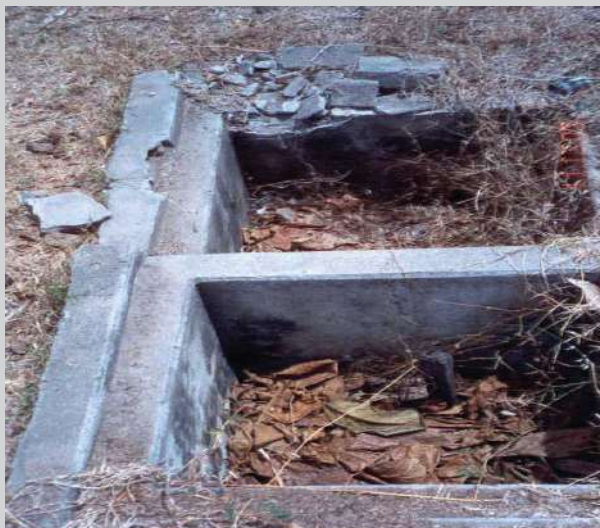
Figura 19 - Ponto de descarga de rede
