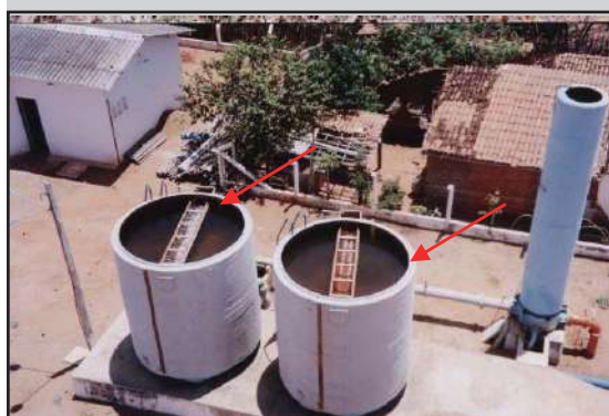
Antes: Filtros ascendentes sem tampas de proteção (fiscalização inicial em 15 e 16 de setembro/2004)
