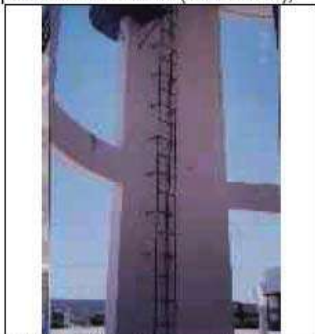
Foto 10 – Vista do reservatório R1 com escada externa de acesso sem gaiola de proteção
