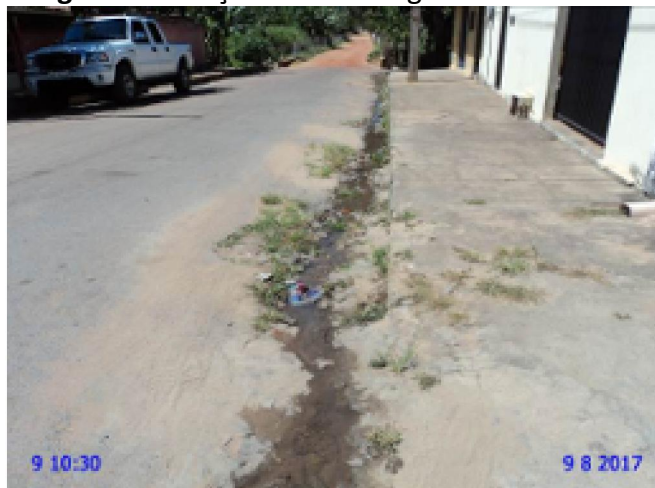
Figura 9 – Lançamento de esgoto à céu aberto
