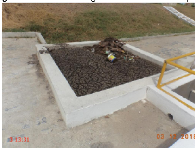
Figura 10 – Leito de secagem necessitando de limpeza
