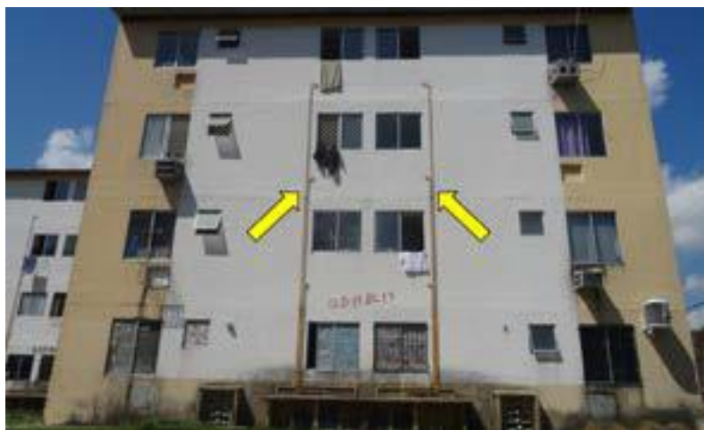
Figura 8 – Instalações prediais de gás – Residencial Viver Melhor
