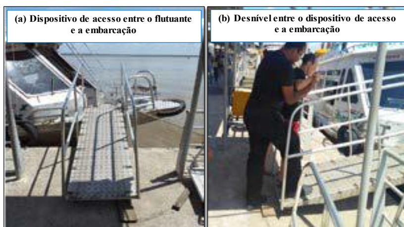
Figura 16 – Dispositivo de acesso da plataforma flutuante a embarcação do terminal THB
