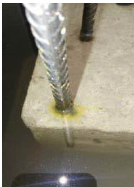
Imagem 02 - Início do processo de corrosão do aço no CP02
