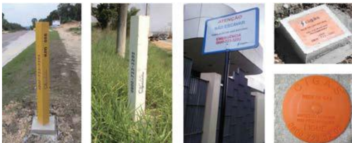
Figura 13 – Marcos e placas utilizados pela Cigás para identificação de sua rede de dutos na área urbana e rodovias. Fotos: Cigás.
