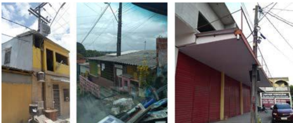
Figura 4 – Obras irregulares com a utilização do poste de energia como estrutura do imóvel, em 19/03/2019 e 10/04/2019.
