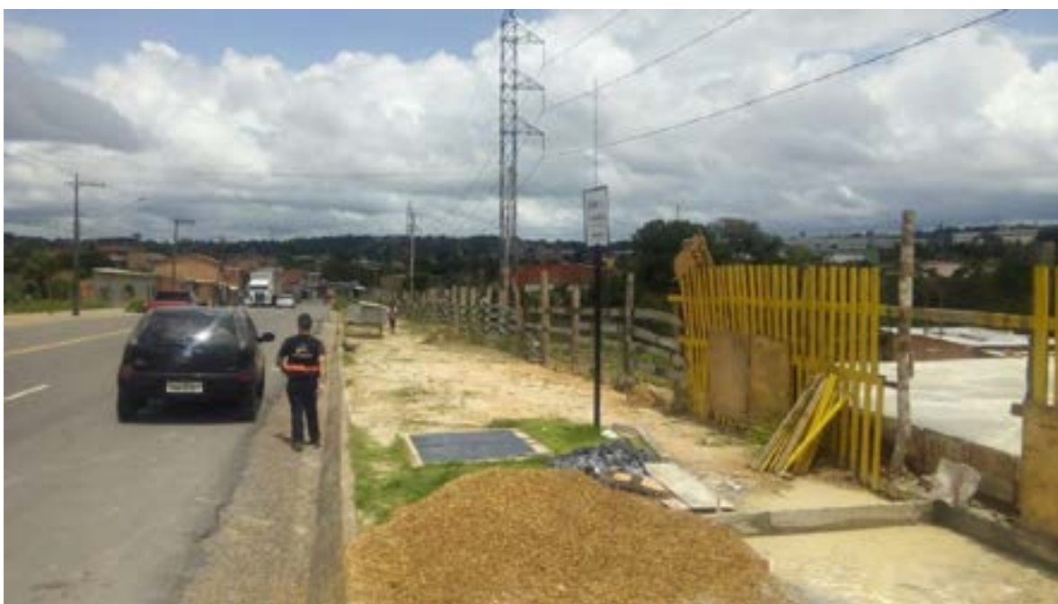
Figura 3 – Obra irregular em área federal e próxima à rede de gás, em 12/02/2019.
