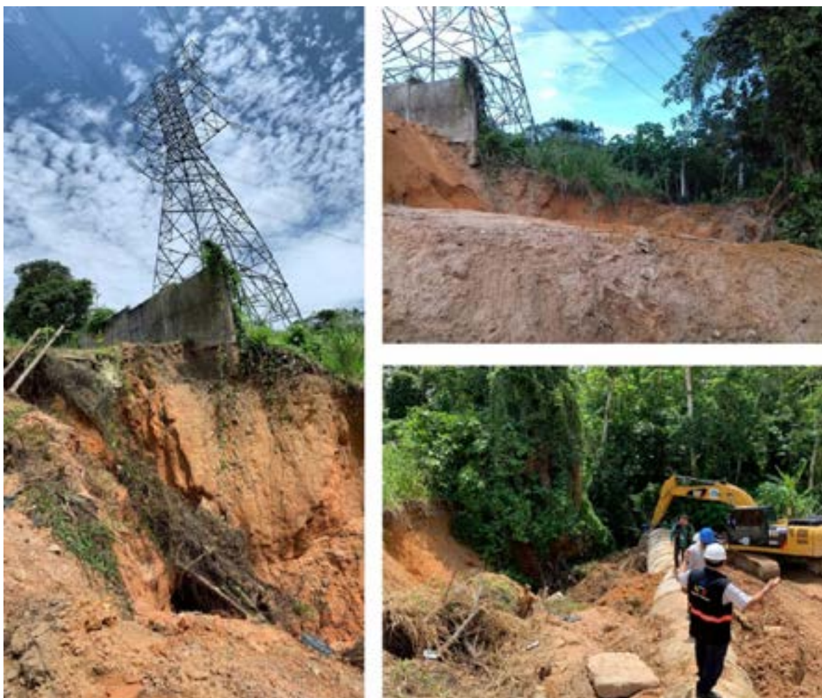
Figura 2 – Vista parcial da torre de energia com o seu entorno comprometido pela erosão, ocasionada pela rede de drenagem e a fiscalização da ARSAM durante a execução da obra.
