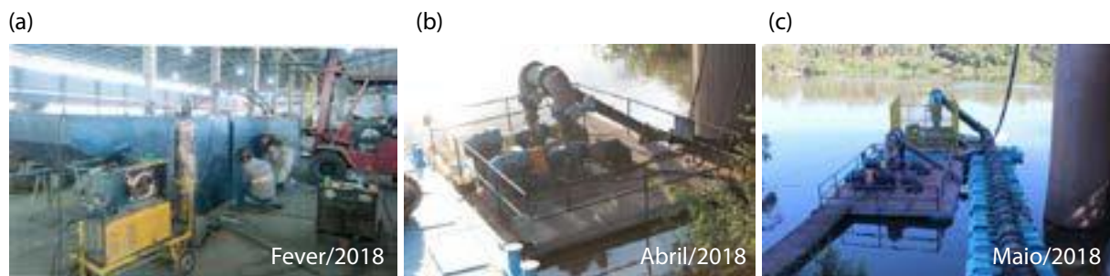
Figura 5 – Conjunto moto-bomba para aumento de capacidade na captação da ETA Ribeirão do Lipa.
