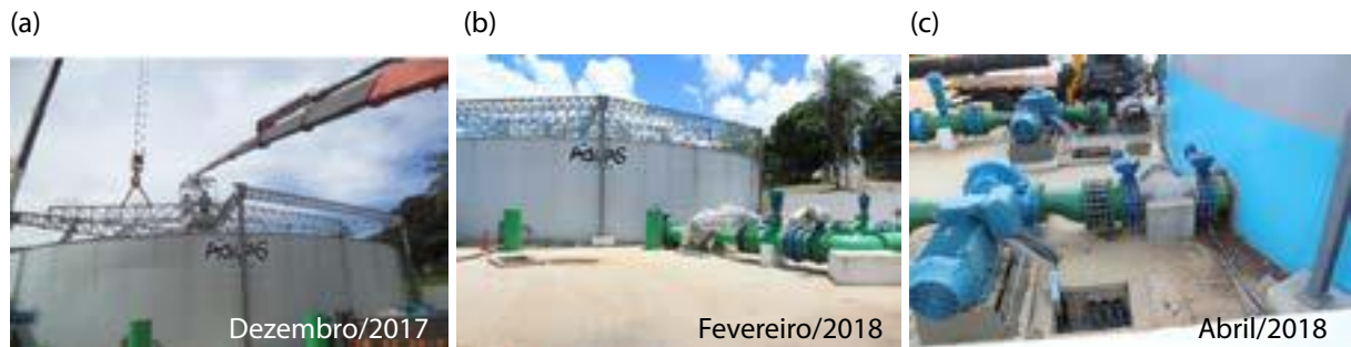
Figura 8 – (a) Sustentação do RAP já existente e (b) Instalação do conjunto moto-bomba EEAT Altos do Ribeirão.
