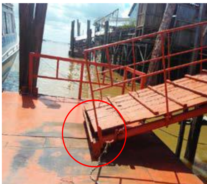
Figura 15 – Desnível verificado no dispositivo de acesso do cais à plataforma flutuante do terminal Shalom.
