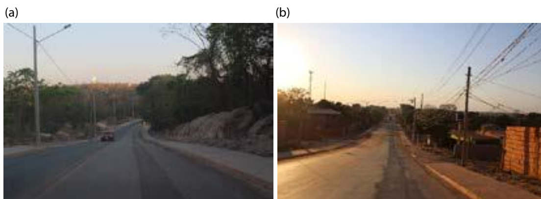
Figura 15 – Implantação das adutoras com retaguarda no RAP Inpe: (a) Linha Novo Paraíso, (b) Linha Jardim Florianópolis.
