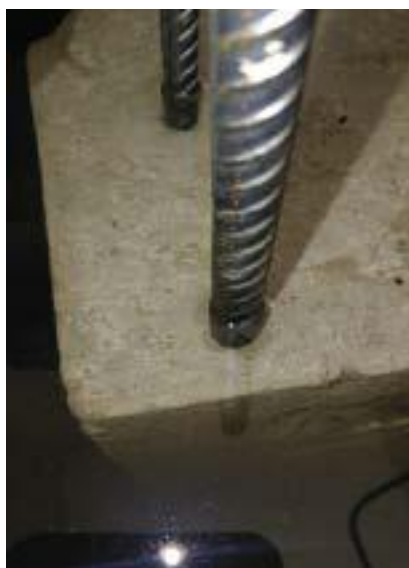
Imagem 03 - Início do processo de corrosão do aço no CP01
