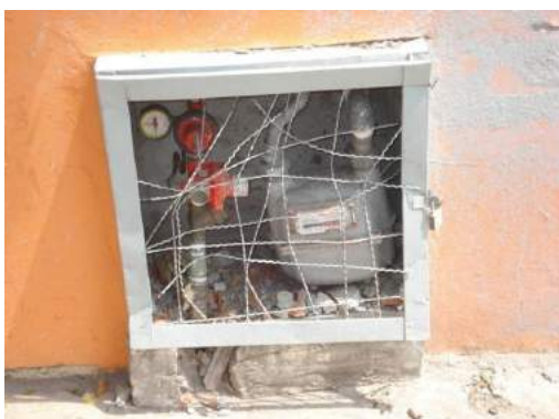
Figura 11 – CRM Comercial Danificado
