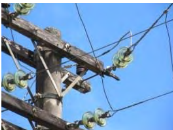
Figura 6 - Cruzeta da rede de distribuição com a ponta totalmente destruída
