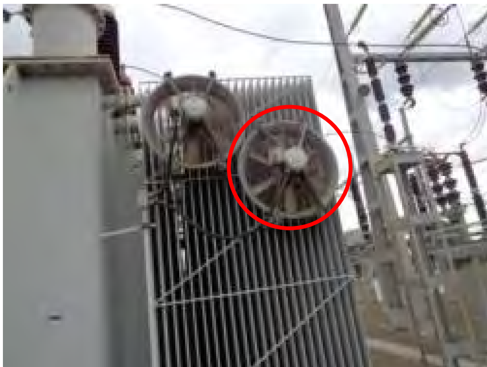
Figura 1 - Transformador de força TR-1 de subestação de distribuição com um ventilador do sistema de ventilação forçada inoperante
