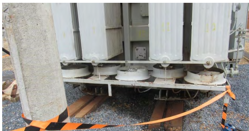
Figura 2 - Transformador de força de subestação de distribuição com marejamento de óleo
