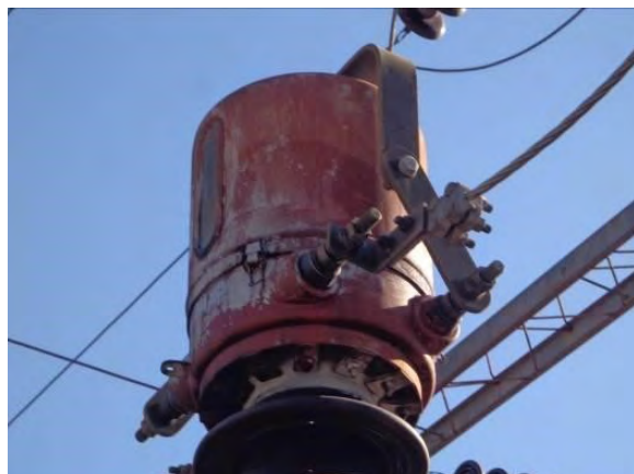
Figura 5 - Transformador de corrente de subestação de distribuição com oxidação e marejamento de óleo na alta tensão
