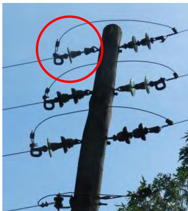
Figura 9 - Isolador quebrado na rede de distribuição
