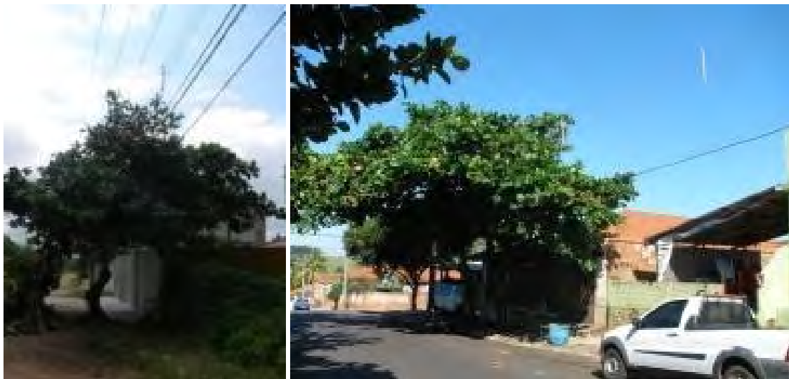
Figura 8 - Vegetação tocando a fiação na rede secundária de distribuição
