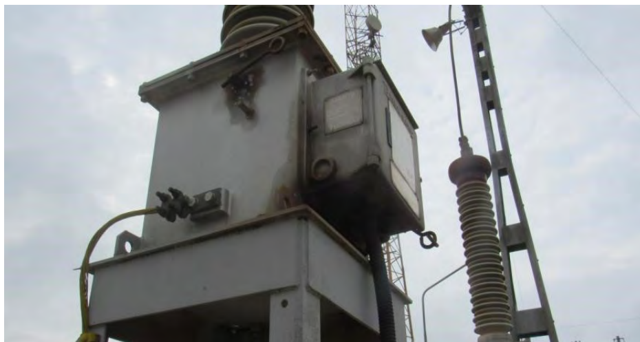
Figura 3 - Transformador de potencial de subestação de distribuição com marejamento de óleo na alta tensão
